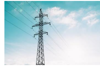
Cabos de Transmissão de Energia Elétrica Fonte: Pixabay acesso em 24 de abr. de 2020
